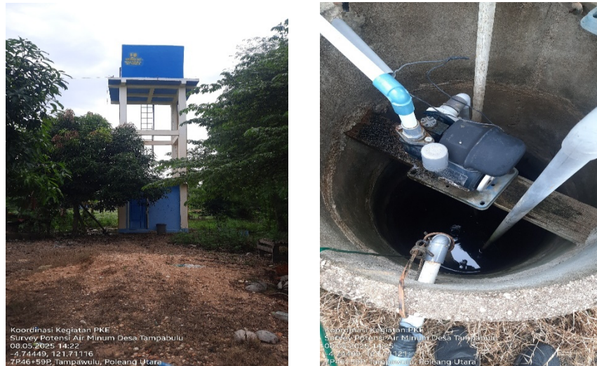
Gambar 3 Reservoir dan Sumur Dangkal Eksisting
